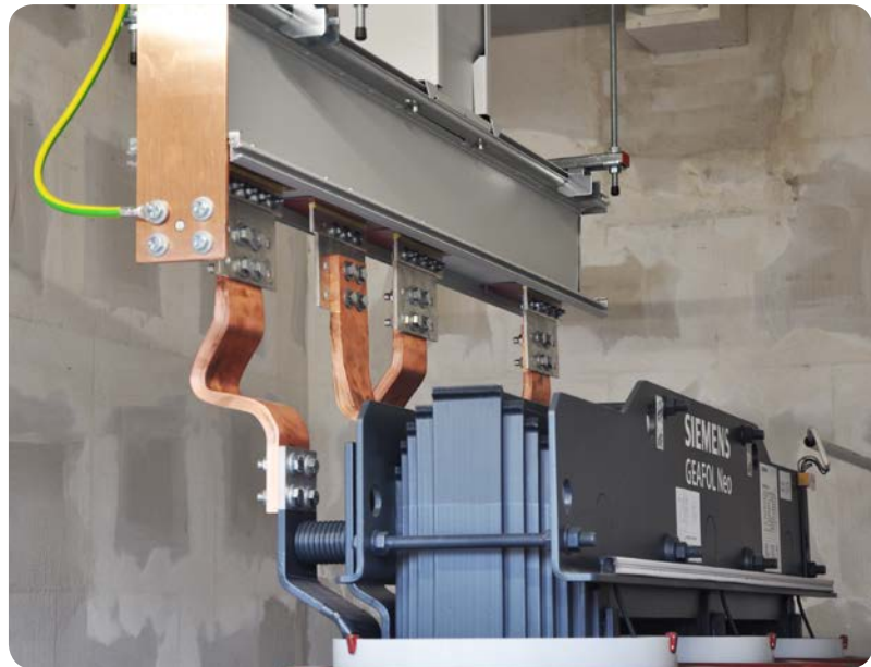
Ein Trockentrafo mit Stromschienenanschluss
