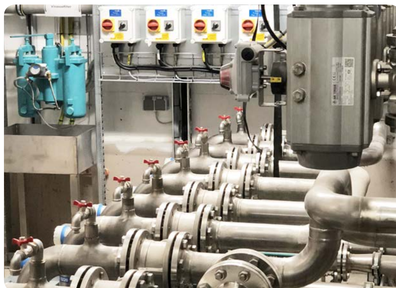
Ein Blick in die neue Anlage
