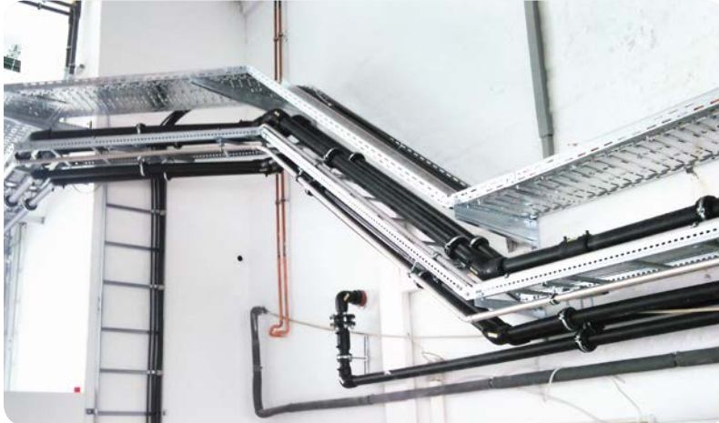
Kunststoff- und Edelstahlrohrleitungen sind auf die Produktionsprozesse abgestimmt
