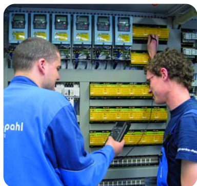
Prüfung der Funktionsfähigkeit der Schaltanlage
