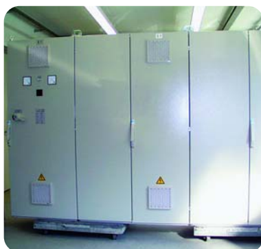
Schaltanlage für E.C.H. Will
