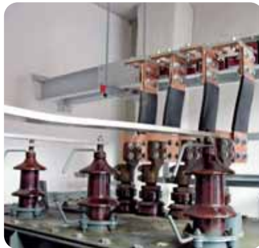
Trafoanschluss über die Stromschiene
