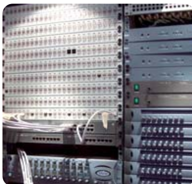
Patch-Panel für Datenleitungen
