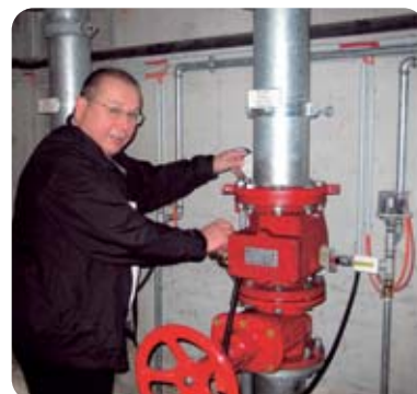
Herr Rath überprüft das Alarmventil der Sprinkleranlage
