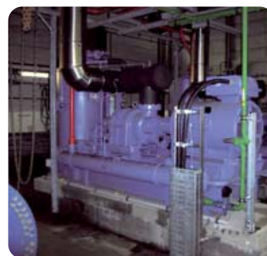
Die beiden neuen Schraubenverdichter 250 kW
