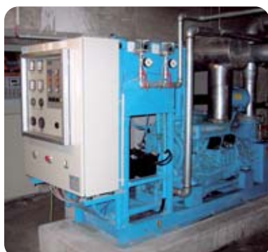
Das Notstromaggregat der Sprinklerpumpe
