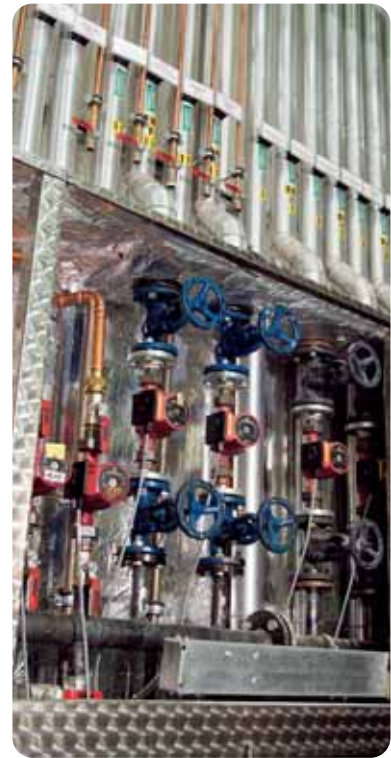
Eine Rohrbegleitheizung bei einem Nahrungsmittel-Hersteller
