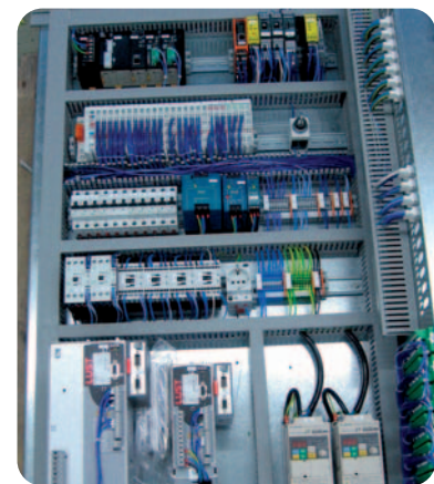
So kann eine Schaltanlage aussehen
