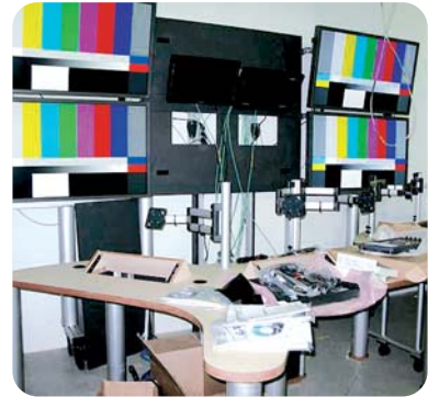
Ein Regieraum – in Vorbereitung ...
